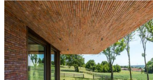
metselwerk doorgezet onder het overstek
